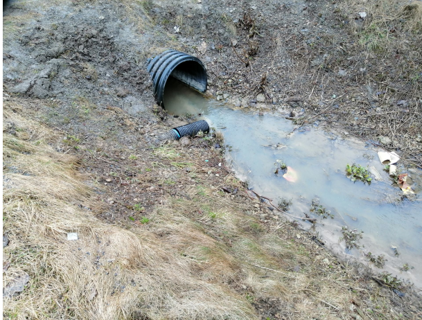
Foto 11. Sademeveetoru suubumine kraavi (kp 12.04.2021. a)
